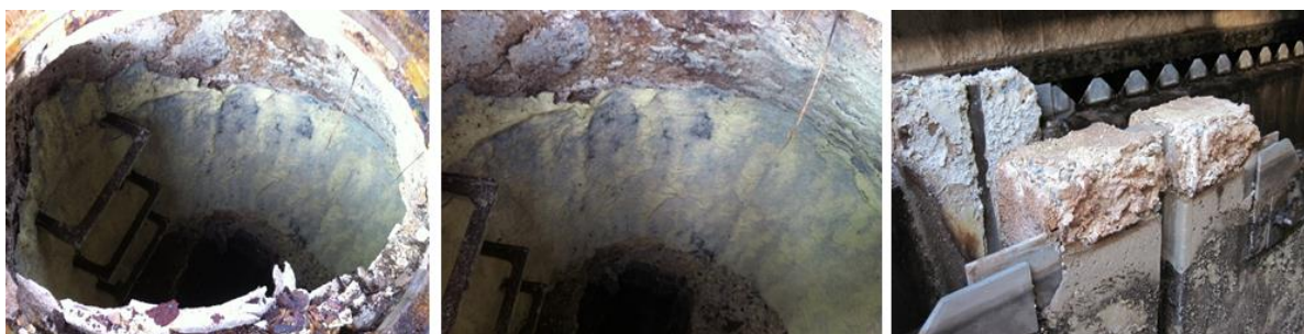
Fig. 2 – Imagens de corrosão pelo H_2S com formação de etringite e gesso.
