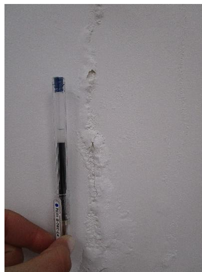
Fig.4 – Tipo de manchas de humidade na parede da sala.
