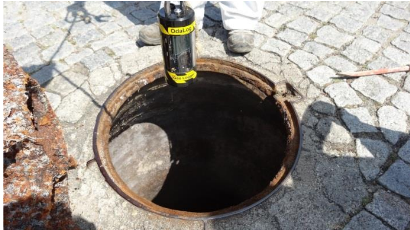
Fig. 7 – Instalação de Datalog para leitura de H 2 S.
